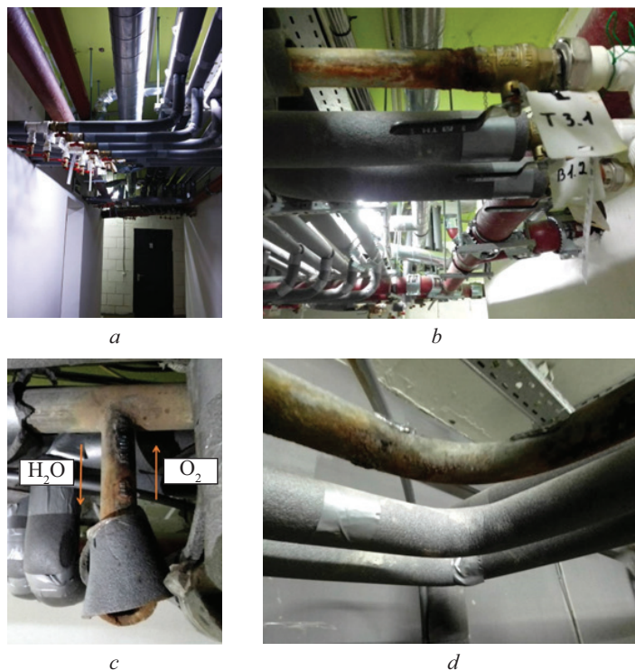
Рис. 4. Фотографии аварийных участков: a — присоединение стояков к магистральным трубопроводам в подвале; b–d — участки труб со свищами
