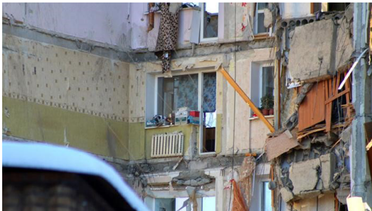
Рис. 6. Фото разрушений строительных конструкций после взрыва в жилом доме, из которого следует, что прогрессирующее обрушение этой части здания произошло в результате потери несущей способности железобетонных перекрытий. При этом остекление проемов наружных ограждений не выполнило свою функцию как меры взрывозащиты
