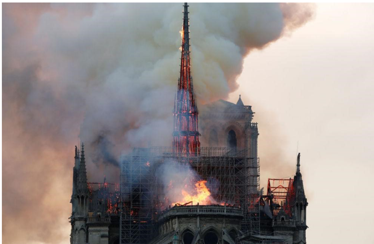
Рис. 10. Начало пожара в соборе у основания шпиля
