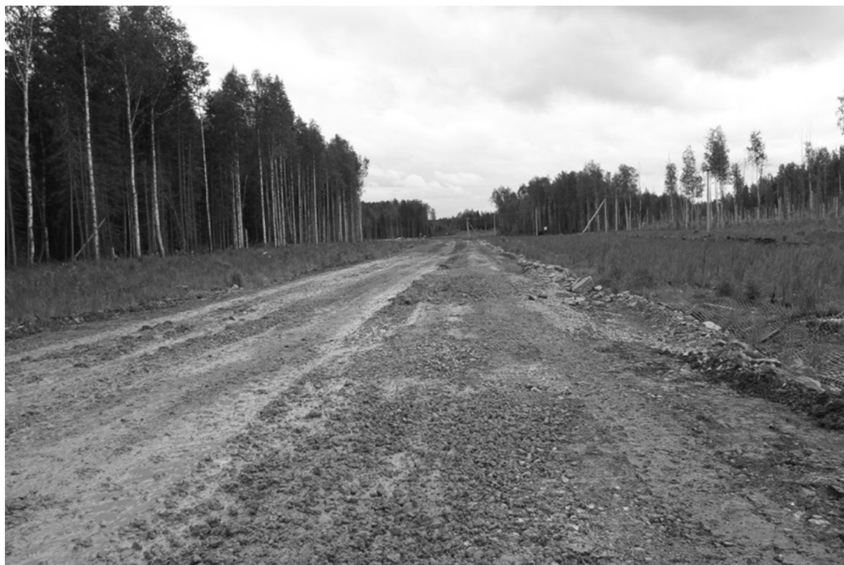
Рис. 1. Состояние дорожной насыпи на 2019 г.: щебень, вдавленный в верхний слой насыпи; открытые обломки мергеля, подверженные разрушению на откосах
