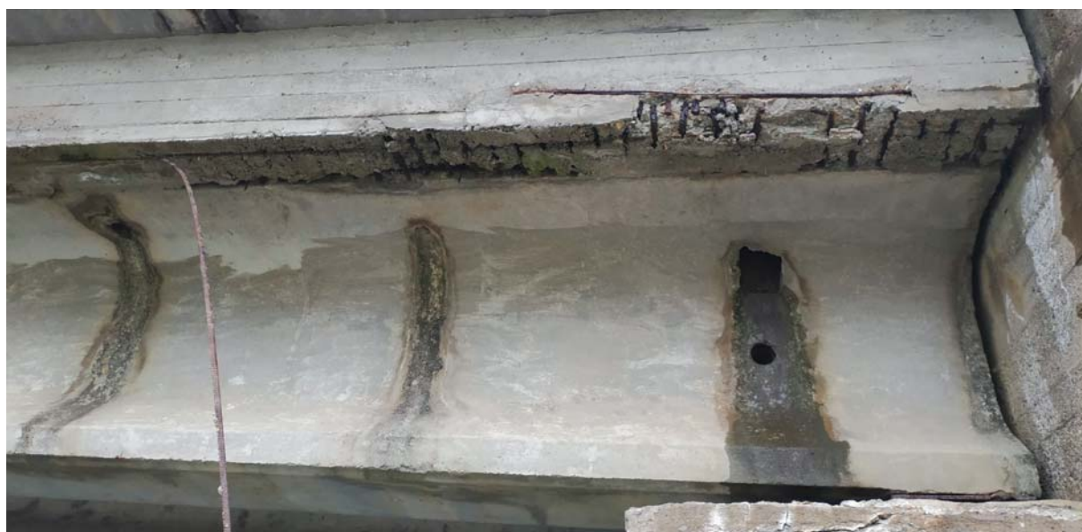
Рис. 8. Выщелачивание бетона на балках пролетного строения, намокание балок пролетного строения
