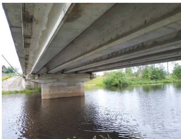
Рис. 6. Протечки на консоли в пролете № 1 Fig. 6. Leaks in the cantilever of span 1
