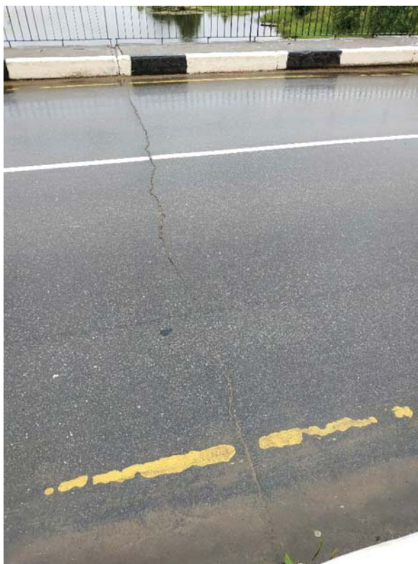
Рис. 4. Трещина над деформационным швом Fig. 4. Crack above the expansion joint
