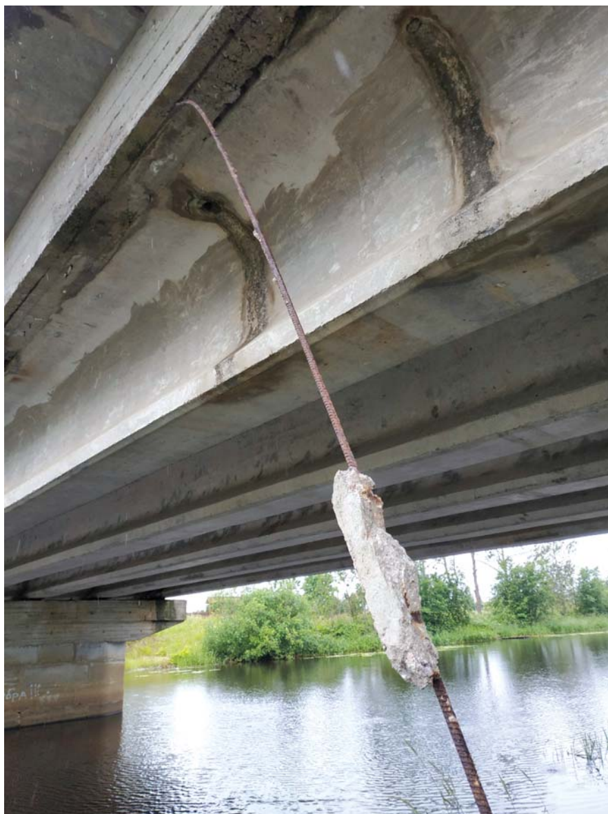
Рис. 9. Отрыв арматуры от балок пролетного строения
