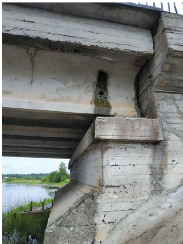
Рис. 11. Биопоражения Fig. 11. Biological damage
