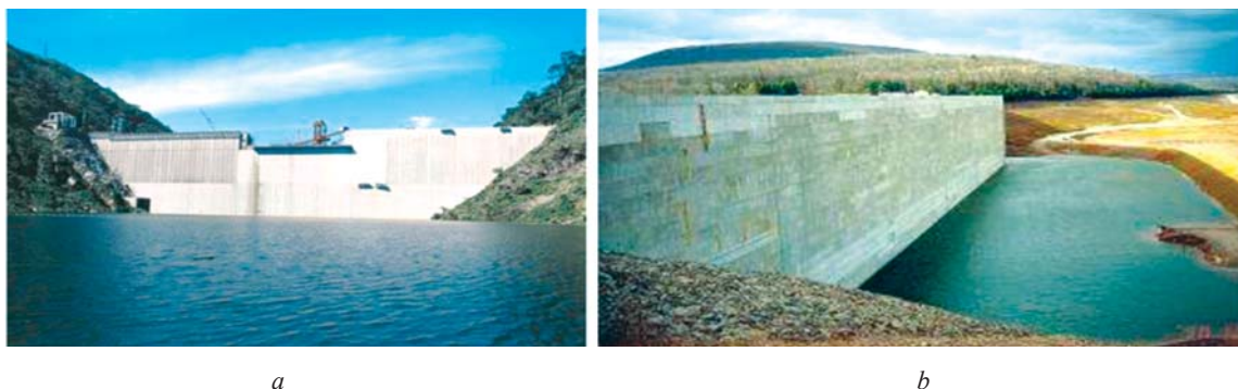
Рис. 6. Геокомпозитные системы, установленные на напорных гранях плотин: a — плотина Миэль I, Колумбия, 2002, открытая геокомпозитная система; b — плотина Пенн Форест, США, 1998, закрытая геокомпозитная система
