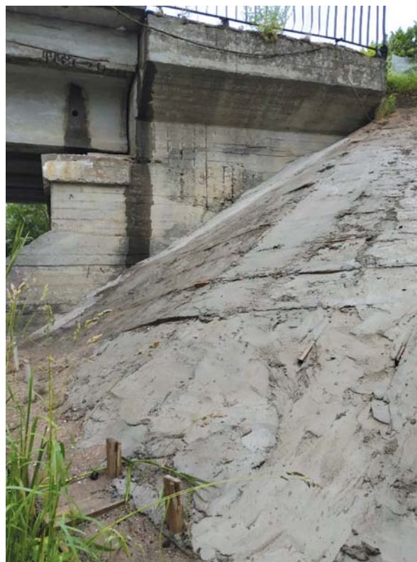
Рис. 12. Обрушение конструкций укрепления конусов Fig. 12. Failure of bridge abutment structures
