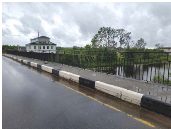
Рис. 5. Деформация перильного ограждения Fig. 5. Deformation of safety rails
