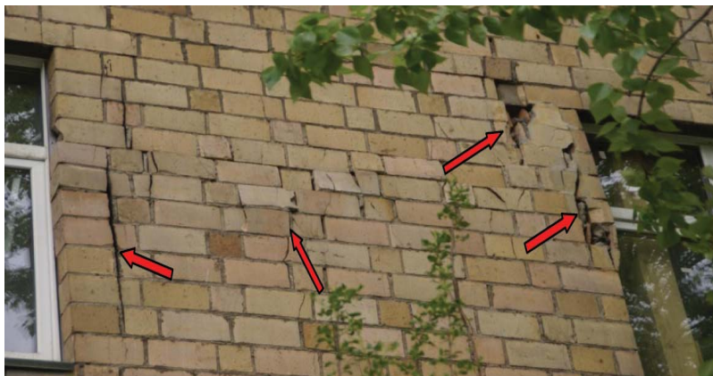
Рис. 1. Разрушение кирпичной кладки по оси 5 в уровне 2-го этажа
