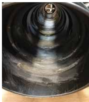
Рис. 2. Трубопровод системы АСО Qmax с имитацией частичного заиливания придонной части
