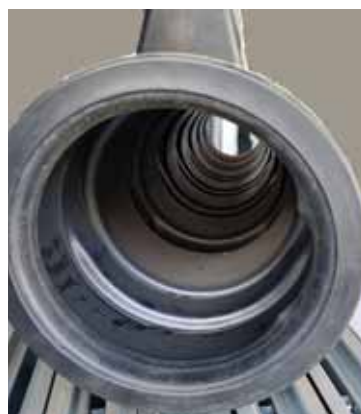
Рис. 1. Трубопровод системы АСО Qmax при отсутствии заиливания
