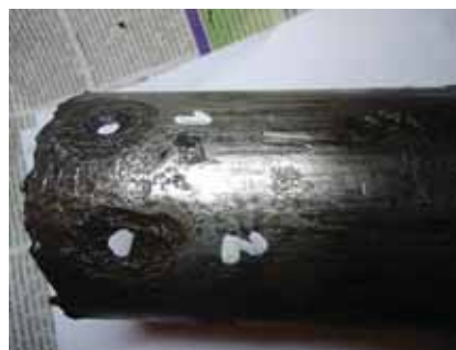
Рис. 4. Газопровод, поврежденный коррозией (иллюстрация авторов)
