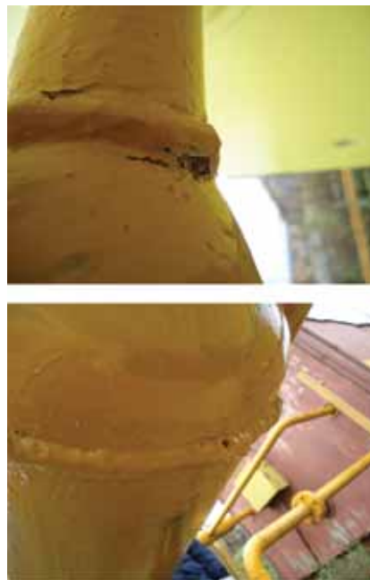
Рис. 3. Дефекты монтажных и сварочных работ на пункте редуцирования (иллюстрация авторов)
