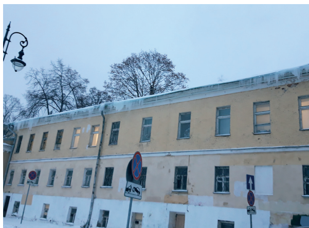
Рис. 6. Наледи на скатной крыше общественного здания (Москва, Хитровский пер., 21.01.2021)
