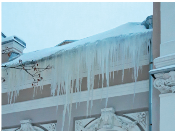
Рис. 5. Наледи на скатной крыше исторического особняка (Москва, Покровский бульвар, 21.01.2021)
