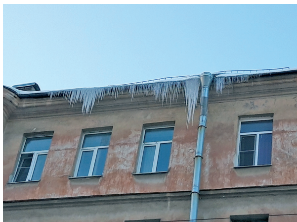
Рис. 2. Сосульки на карнизном свесе крыши Fig. 2. Icicles on the eaves edge of a roof
