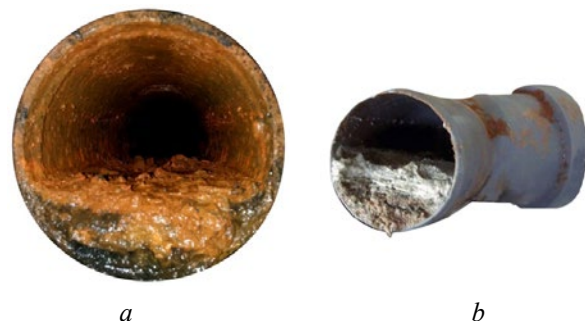
Рис. 3. Отложения в лотковой части труб из разных материалов: а — бетонные трубы; б — трубы из поливинилхлорида
