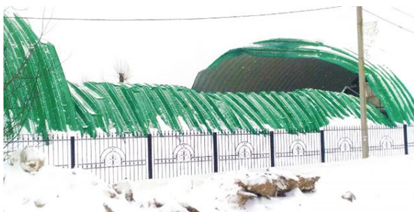
Рис. 2. Обрушение арочного покрытия складского ангара
