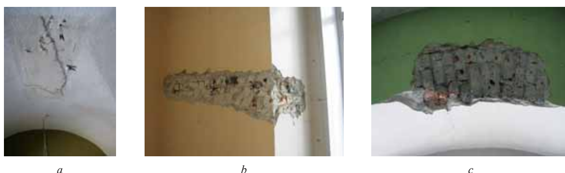
Рис. 1. Трещины внутренней штукатурки из-за наличия в ней скрытой электропроводки (а); неоднородности каменной кладки простенка (b) и арочной перемычки (с)
