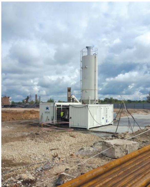
Рис. 3. Высоконапорная насосная станция Fig. 3. High-pressure pumping station
