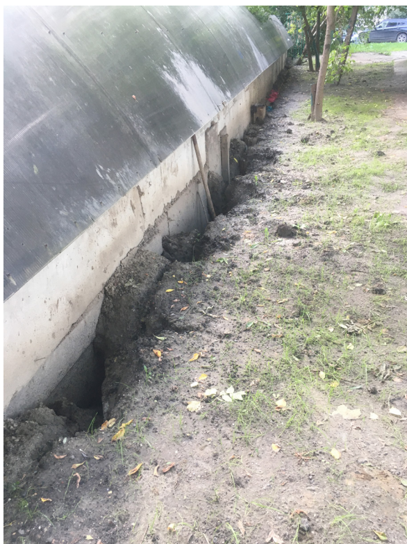
Рис. 1. Суффозия. Объект — жилой дом (г. Москва, ул. Малыгина, д. 12). Въезд на парковку
