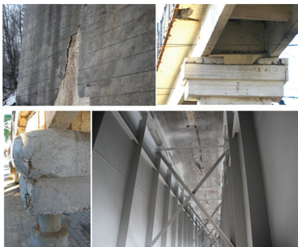
Рис. 1. Конструкции мостов с высокой степенью износа
